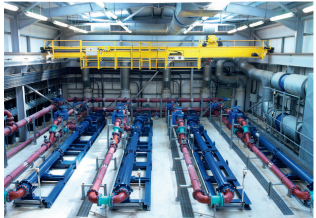
Vier Pumpen der Baureihe N 300-36T fördern seit Jahren stündlich 180 m 3 Faulschlamm mit 5 % Trockenstoffgehalt über eine Entfernung von 16 km.
