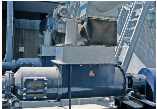
Einlauftrichter mit Reinigungsdeckel und Ultraschallsensor an Pumpe der Baureihe THE 300-27TH.
